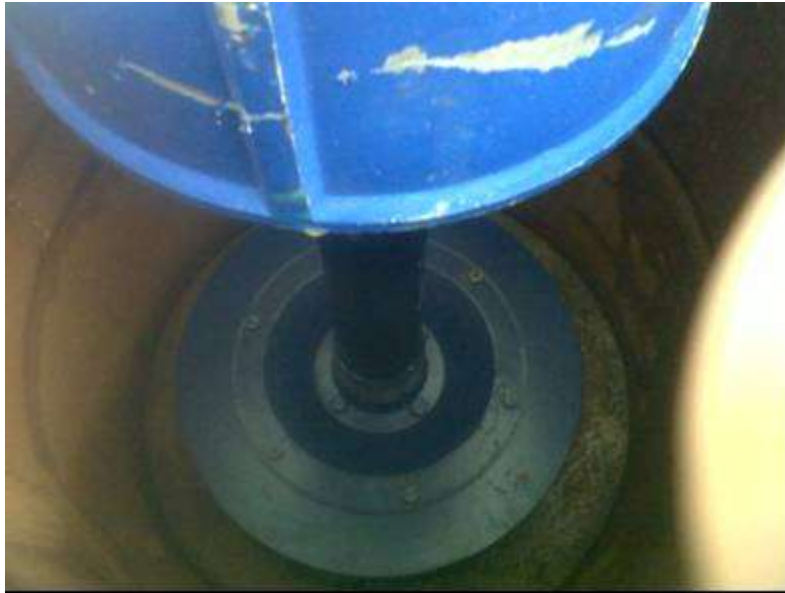
TURBINA GENERADOR DENTRO DEL TANQUE
