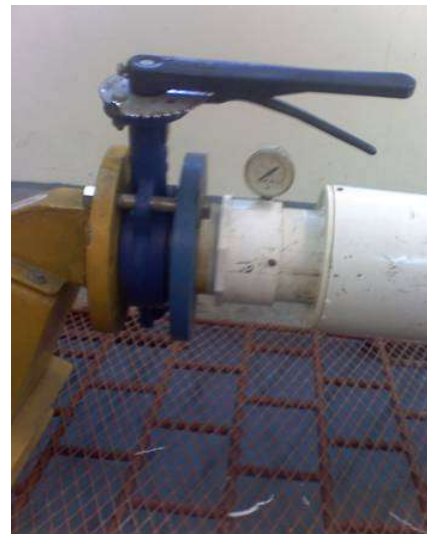
Foto 2.12 Conexión de Tubería Turbina CLE 1000
