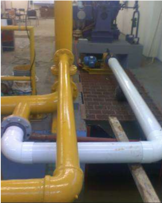
TUBERÍA DE ALIMENTACION A LA TURBINA
