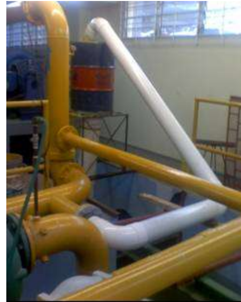
TUBERÍA DE ALIMENTACIÓN AL TANQUE DE LA TURBINA
