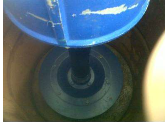
Foto 2.10 Turbina MHG 1000 Dentro del Tanque
