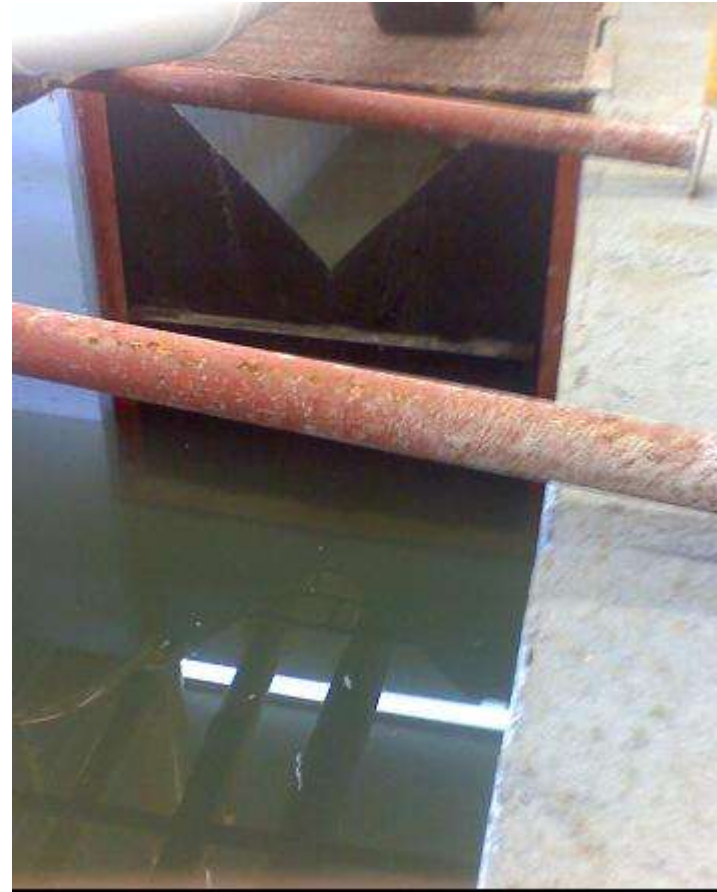
VERTEDERO EN V PARA MEDIR EL FLUJO DE ALIMENTACIÓN A LA TURBINA
