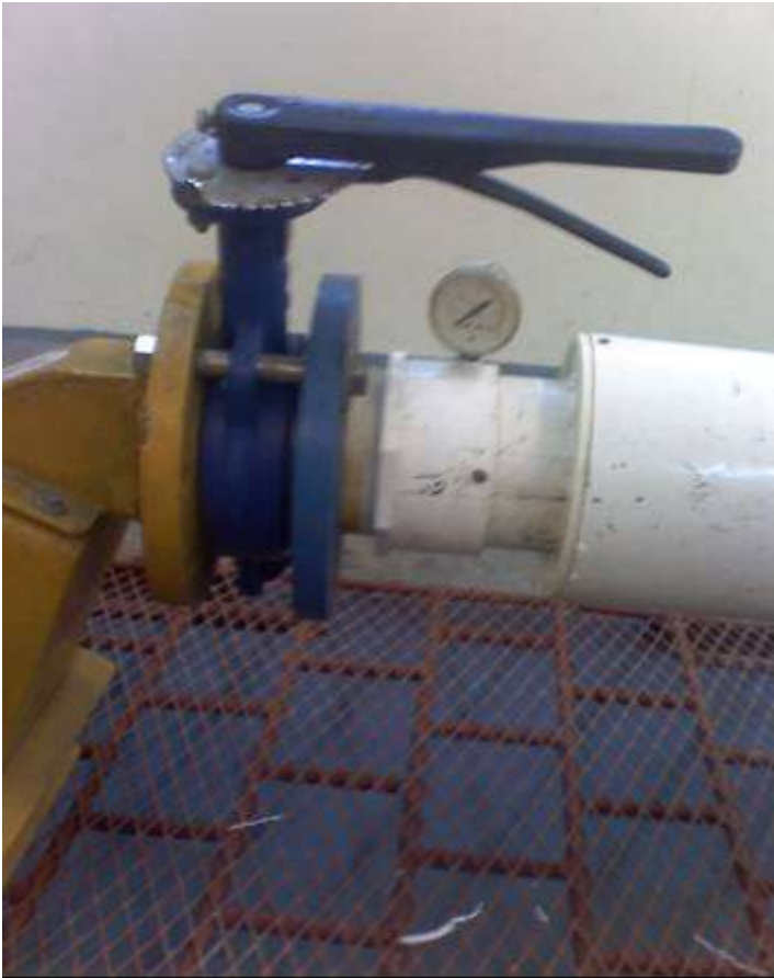
MANÓMETRO Y VÁLVULA A LA ENTRADA DE LA TUBERÍA DE ALIMENTACION A LA TURBINA
