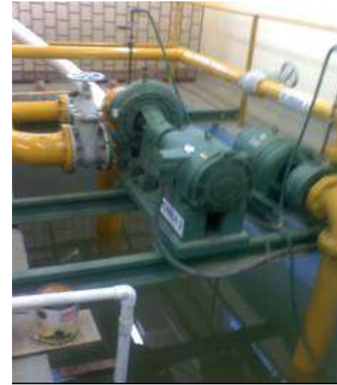
BOMBAS DE ALIMENTACIÓN AL TANQUE DE LA TURBINA
