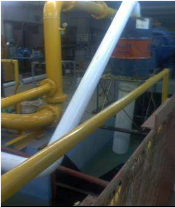
TUBERÍA DE ALIMENTACIÓN AL TANQUE DE LA TURBINA
