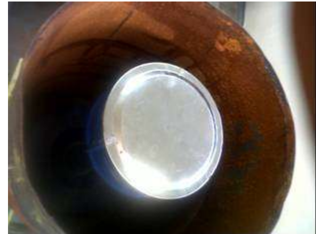
TURBINA GENERADOR DENTRO DEL TANQUE
